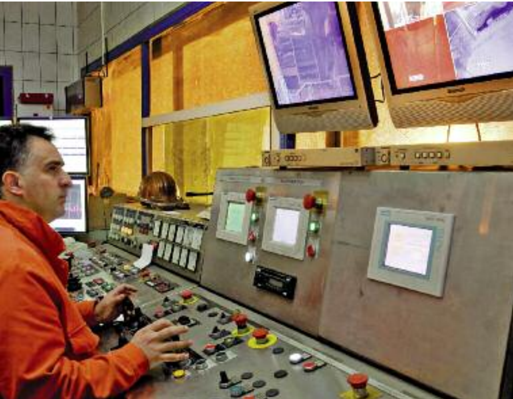
Der Ofenmeister hat in seinem hitzegeschützten Kommandoraum den direkten Blick auf den Ofen. Mit Hilfe der Bildschirme behält er die Übersicht über die Zusatzeinrichtungen bis zum Ofen und über die Chargenzusammensetzung sowie die Metallproben, die ihm übermittelt werden.
