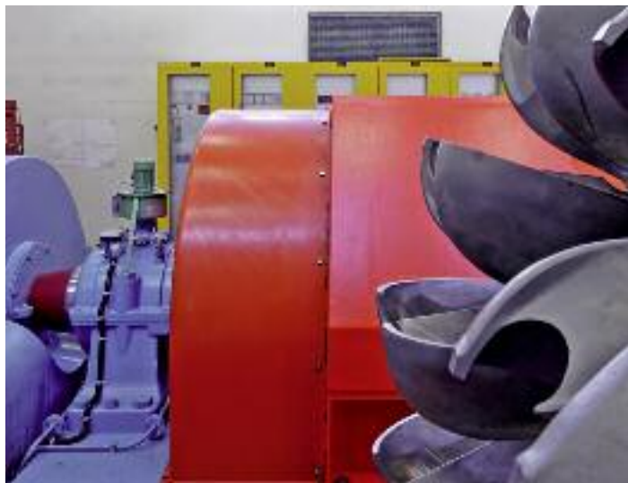
Die eingesetzte Turbine produziert mit dem Generator sauberen Strom für die Umwelt.
