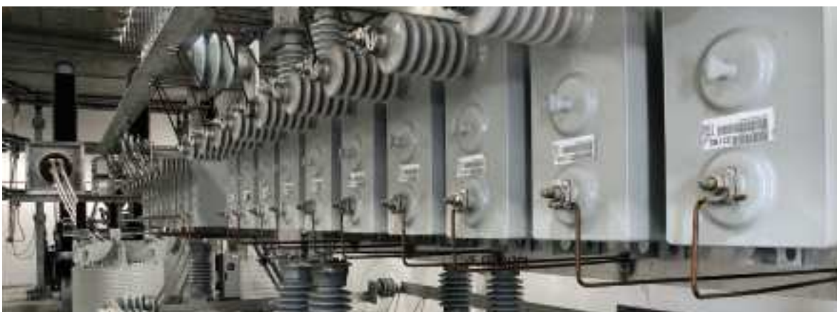
Schlüsselkomponenten einer Blindleistungskompensationsanlage von PTD, die das Stromübertragungsnetz im Süden Dänemarks stabilisiert.
