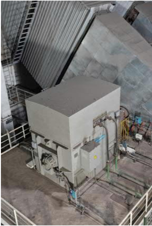
太钢4号烧结机采用的10,760kW西门子高压电机
