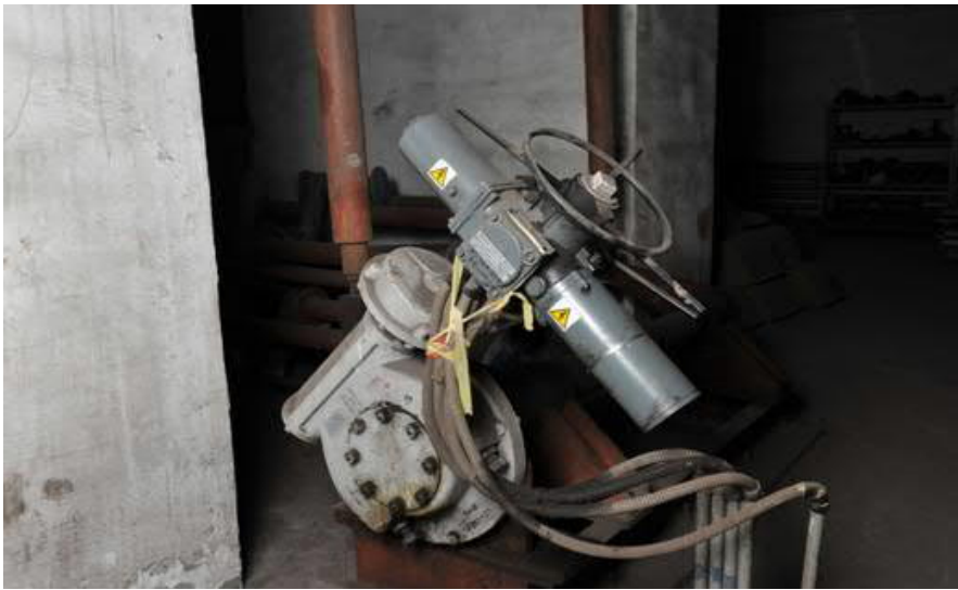
采用变频调速之前太钢曾经使用风门挡板调节风量
