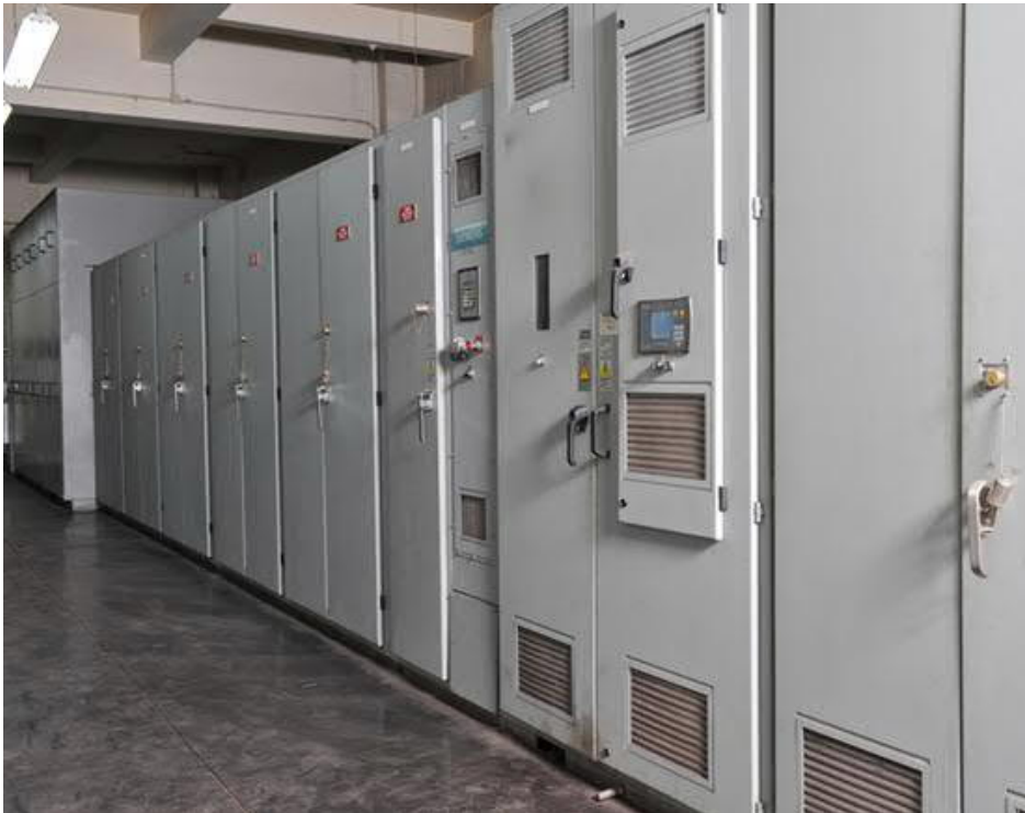
15,000kVA西门子罗宾康变频器机柜
