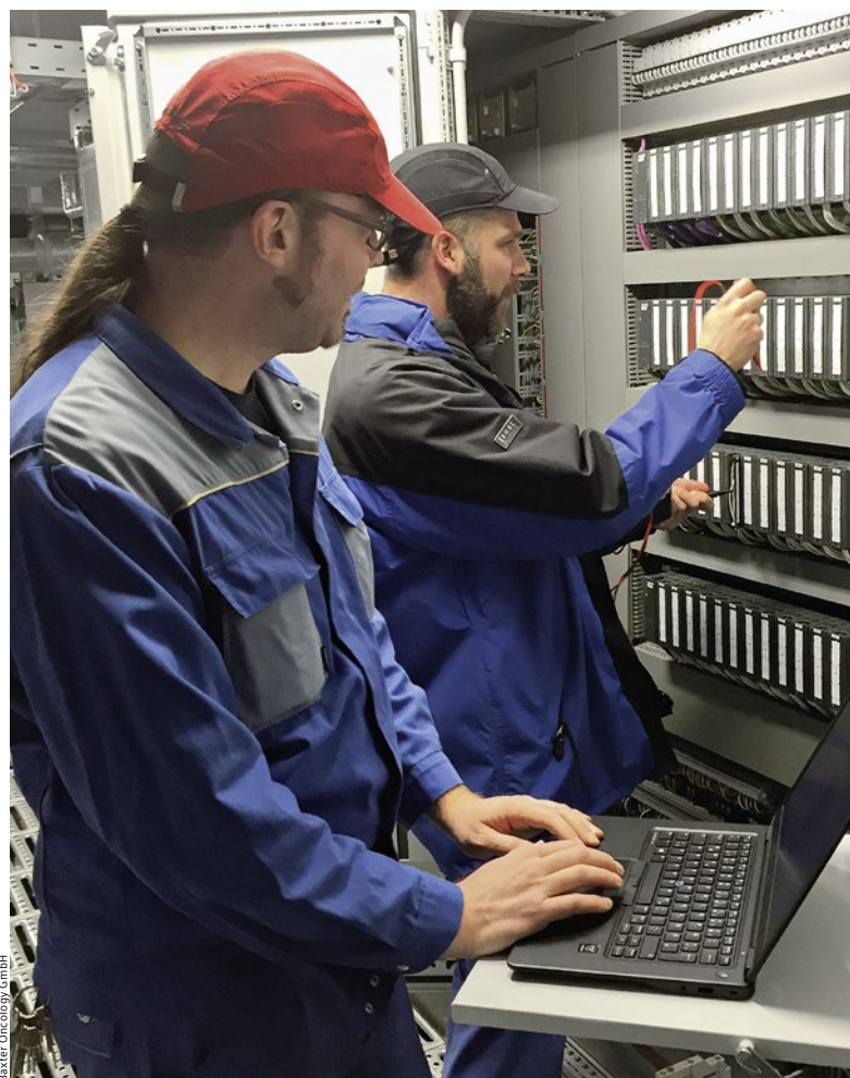
Die Anlage zur Steuerung der Raumkonditionen wird von Baxter-Mitarbeitern über das vertraute Automationssystem bedient
