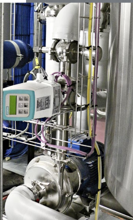
Ein starkes Team: Sitrans F M MAG 6000 mit Sitrans P Compact und Sitrans TS300 zur genauen Messung von Durchfluss, Druck und Temperatur ...
