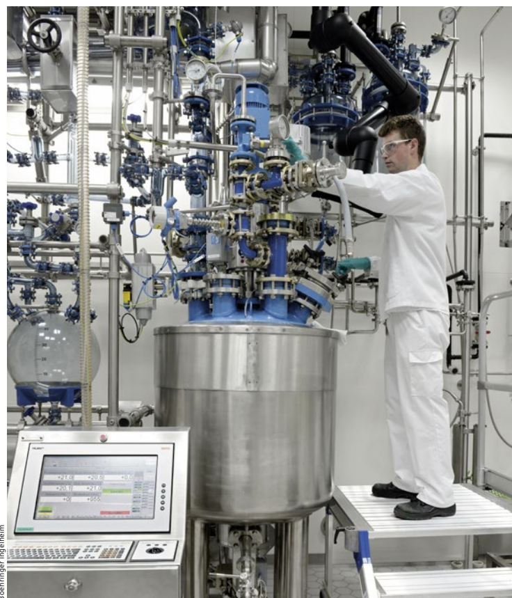
Die neue Anlage von Boehringer Ingelheim zu Herstellung von Wirkstoffen wurde an die Anforderungen des Betreibers angepasst
