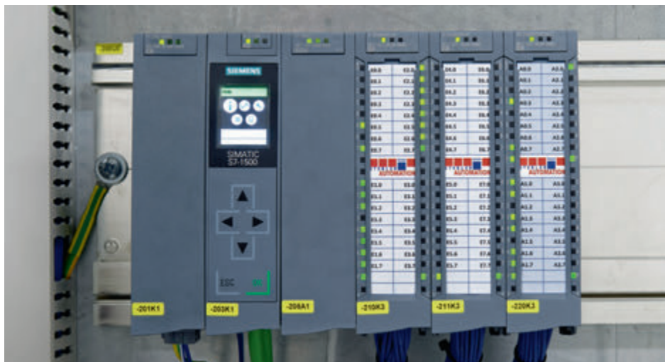
Armoire de commande principale dans la centrale: les cinq ascenseurs à palettes sont pilotés par la Simatic S7-1500.
