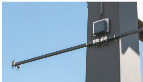
Die Access Points SCALANCE W786 sind an den Stützen der Bahn installiert und kommunizieren über zwei Antennen an den Auslegern mit den Zügen auf den beiden Fahrgeleisen.
