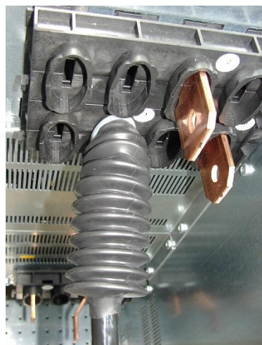
Conexão de um cabo Connection of one cable
