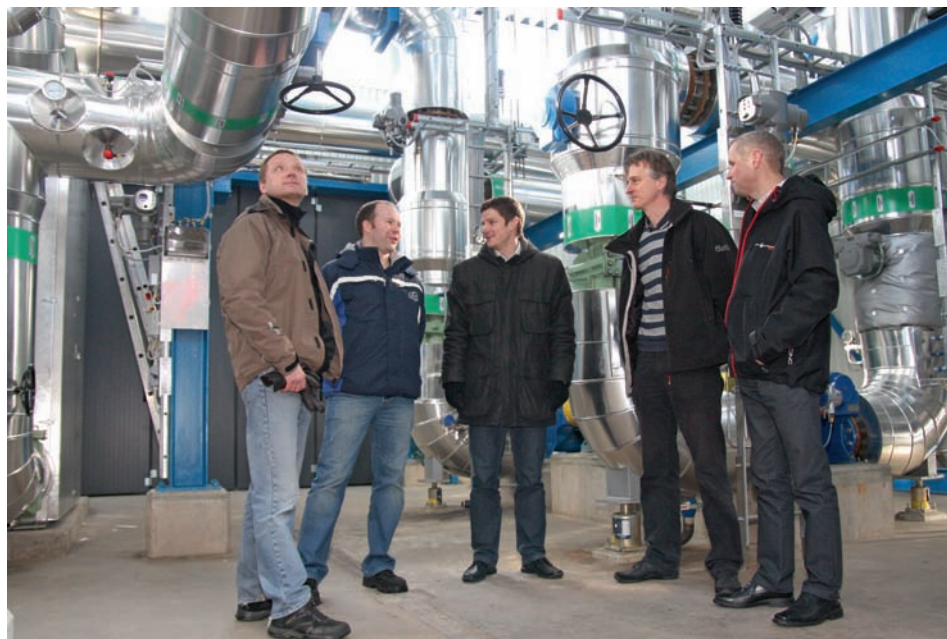
Peter Gustafsson och Dan Mörck från Rejlers, Krister Syrtén från Siemens och Jan Sandberg och Martin den Hartog från Rejlers har samlats på den nya tryckstegrings- och växlarstationen på Nolgård, Hammarö.
