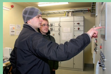
Multipanelen Simatic MP 377 på dörren till det överordnade styrskåpet ger överskådlig information.
