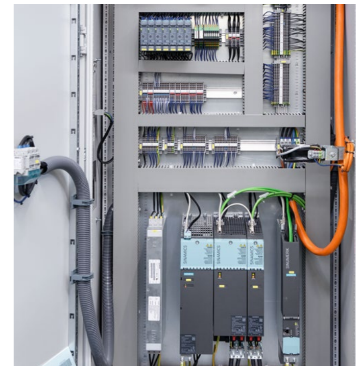
L'armoire électrique spécialement développée pour ces machines fait partie intégrante de la modernisation. Siemens a fourni, en plus de la palette de produits complète, également une gamme de services adéquats.
