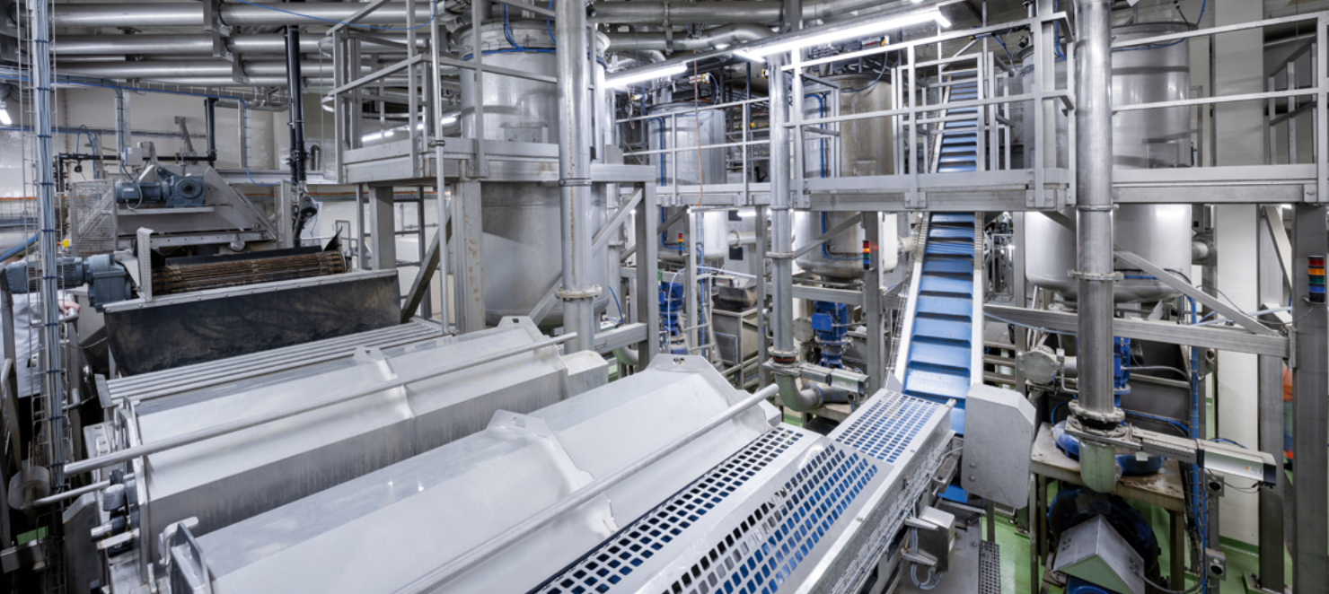
Dank der Offenheit von WinCC Unified und dem Engineering im TIA Portal gelangen Informationen aus dem Produktionsleitsystem von der IT sicher und integriert bis in die Feldebene (OT) – und wieder zurück.
