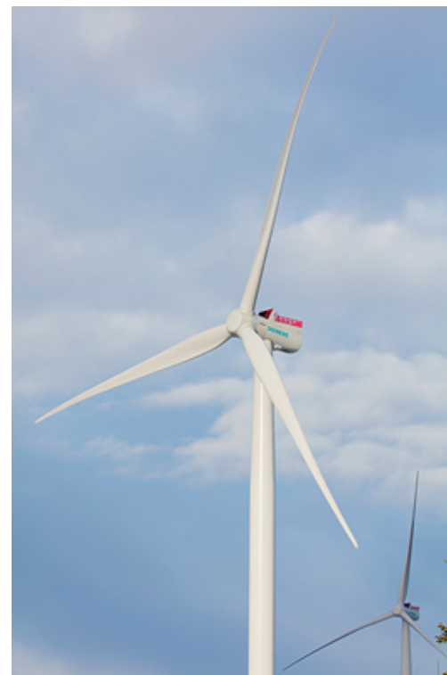
7 MW Turbine (SWT-7.0-154)
