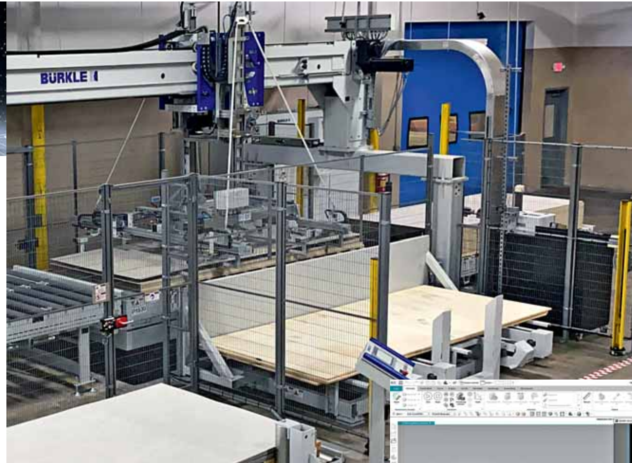
Nach erfolgter Installation und Inbetriebnahme. Seitenansicht Platten-Abstapelung mit Schonplatten-Einzug (Mitte) und Ausfahr-Position der fertigen Stapel (hinten verdeckt), Platten im Durchlauf
