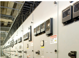
Allis-Chalmers type F 15 kV switchgear
