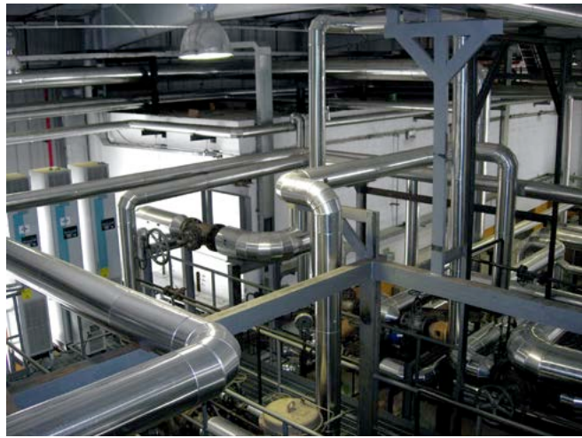
Bild 1: Rohrleitungen der SCHEITER® Heißwasseranlage mit Rückgewinnungssystem einschließlich aller Nebenanlagen für die Reifenindustrie
