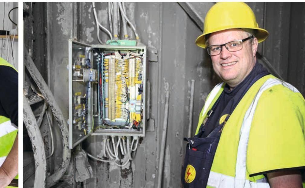
Tomas Knutsson, vd på och ägare av Limhamns Industriservice, vid en moderniserad manöverlåda.
