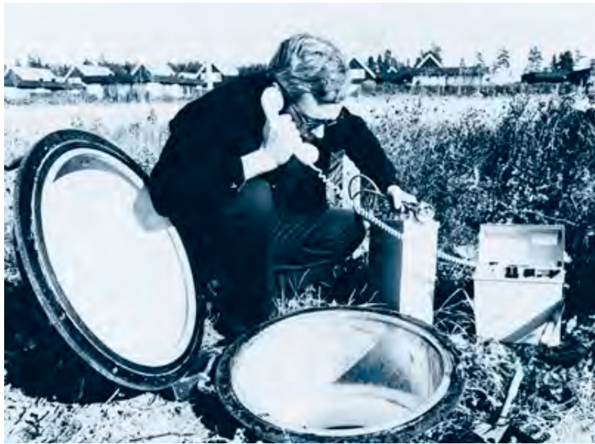
Televerket testar en ledningsförstärkare från Siemens som möjliggör världens första 60 MHz-koaxialkabel mellan Västerås och Örebro år 1952.
