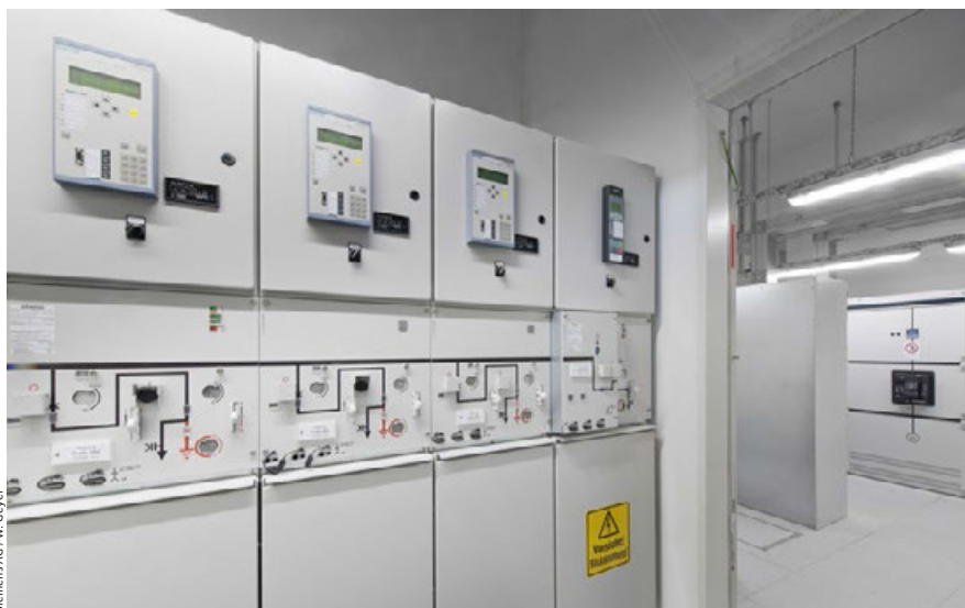
Von der Übergabestation führen zwei eigenständige Versorgungswege zu zwei durch eine Feuerschutzwand getrennte Mittelspannungs-Schaltanlagen vom Typ 8DHJ.
