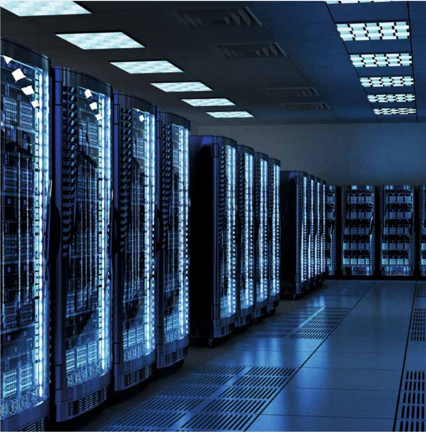
Siemens Building Technologies vanta un portafoglio completo di prestazioni volte a potenziare la sicurezza nei centri di calcolo.
