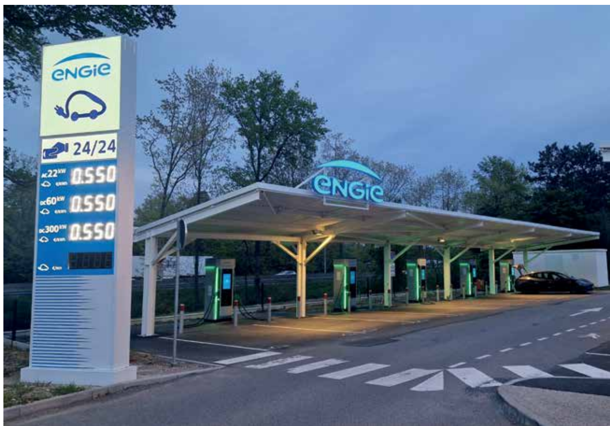
Fornecimento de carregadores elétricos para a Engie Viano
