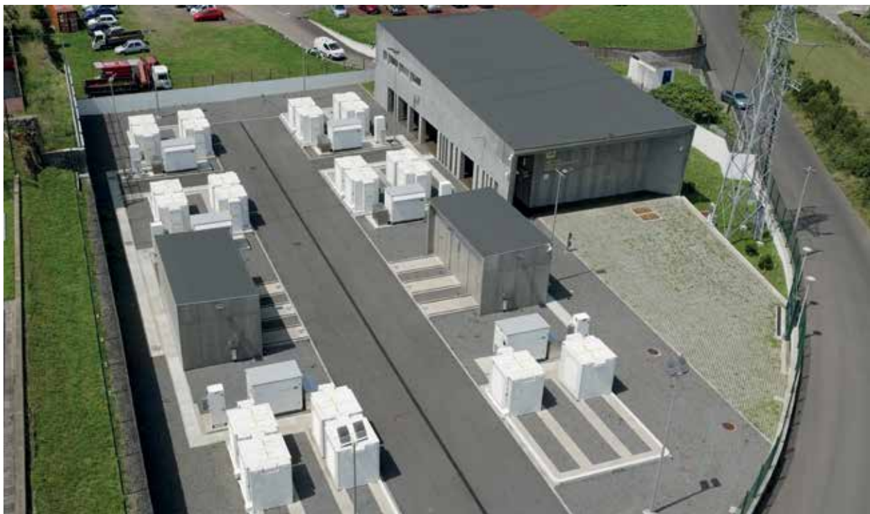
Projeto de armazenamento de energia por baterias na Ilha Terceira, Açores.
