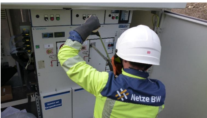
Bild 4: Netzstation bei Netze BW GmbH
