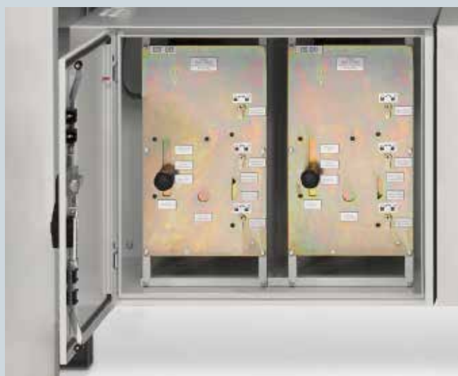
Рис. 19 Шкафы центральных приводных устройств для заземляющих переключателей, разъединителя и пускового разъединителя
