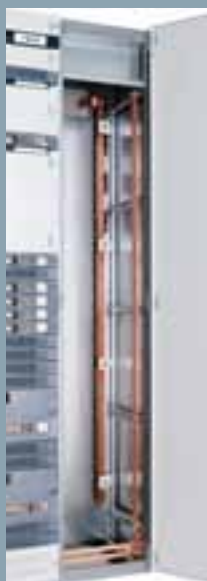
Вертикальные шины РЕ располагаются в отсеке кабельных подключений справа
