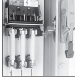
Sectionneur de type MCS avec poignée montée sur bride et profondeur fixe
