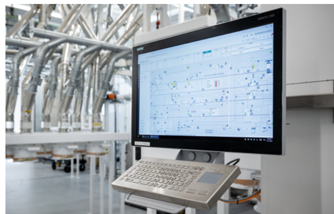
Das Simatic HMI liefert alle für den wichtigen Informationen im Grain Innovation Center von Bühler auf einen Blick.
