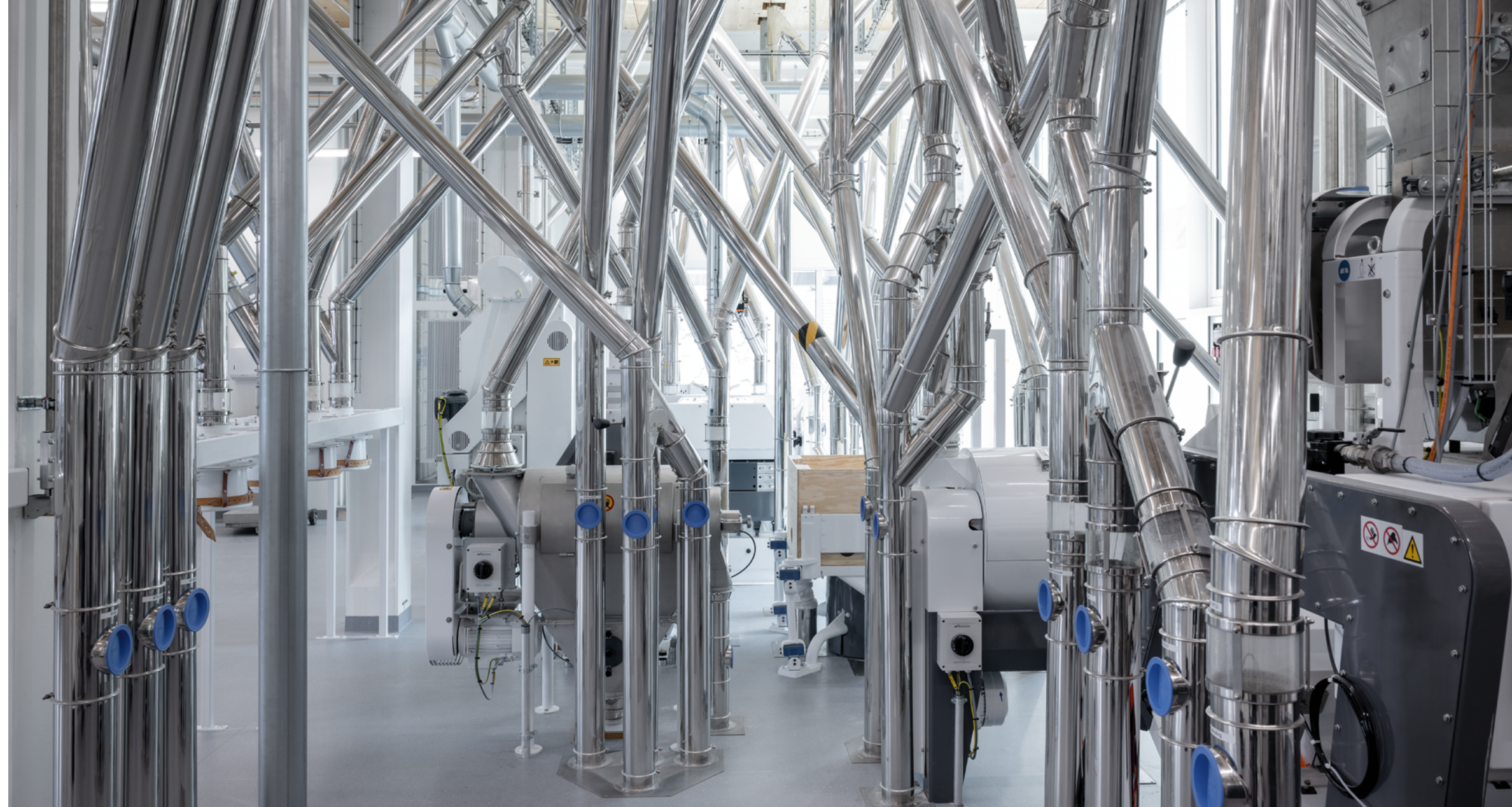
High-End-Mühlenbau: In seinem topmodernen Grain Innovation Center vertraut Bühler bei der Automatisierung auf Siemens.
