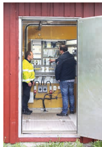
Avloppspumpstation Vränsta på Alnö i Sundsvall. Det gamla styrskåpet med Simatic S5 har ersatts med ett standardskåp med Simatic S7-1500 och Simatic ET 200SP.
