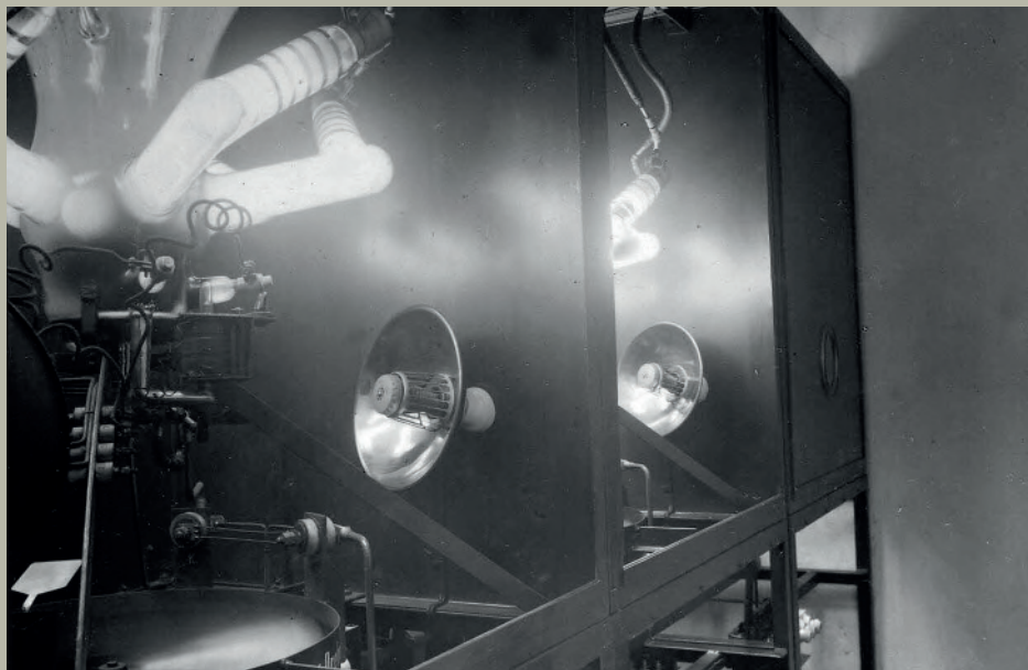
Měnič elektrického proudu. Hotel Imperial, Karlovy Vary
