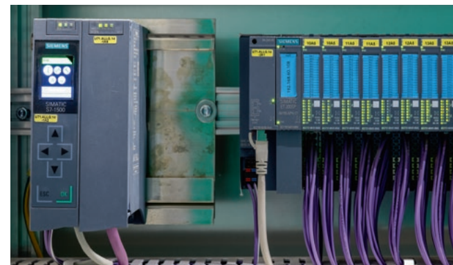
Die Simatic S7-1500 Steuerung und die ET200SP Peripheriemodule sorgen für ein angenehmes Raumklima bei der Felchlin Schokoladenmanufaktur.
