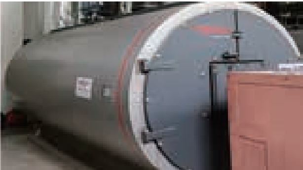
已安装水箱，实现节约蒸汽冷凝水
