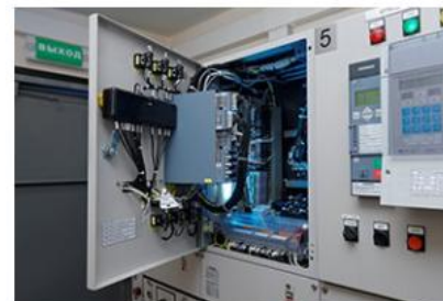
Низковольтный отсек КРУЭ 8DJH
