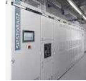
Sistemas de almacenamiento de energía
