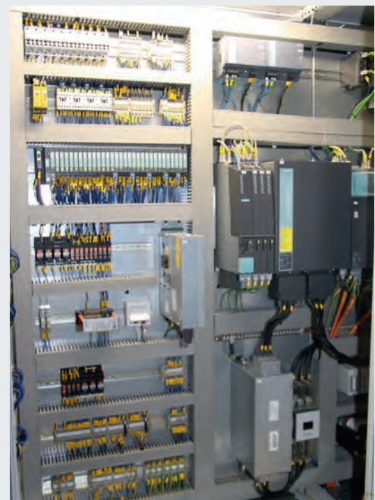
Skåp fullsmetat med processorkraft. Cnc-styrssystemet Sinumerik 840D sl, servosystemet Sinamics S120, distribuerade I/O-systemet Simatic ET 200S, Sirius kontaktorer samt automatsäkringar.
