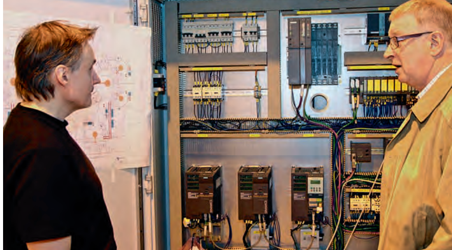
Skåpet som styr hela linjen: Sören Nygren från Goodtech Projects & Services och Christer Sjöberg från Siemens inspekterar den felsäkra plc:n Simatic S7-416F-2 och frekvensomriktarna Sinamics G120.
