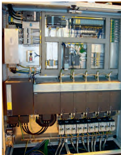
1,4 meter brett och felsäkert är servosystemet, Sinamics S120 Safety Integrated. I skåpet sitter även distribuerade I/O Simatic ET 200S, kontaktorer Sirius 3R samt Sitop power och Sitop select.
