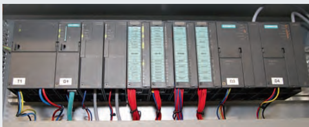
Telecontrols-systemet Sinaut i skåpet på en av tryckstegrings-stationerna. Sinaut samlar in nivå-, temperatur- och tryckvärden och ger larm och driftindikeringar.
