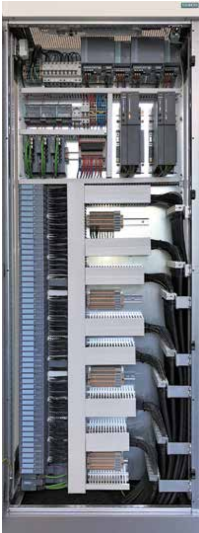
Schaltschrank mit SIMATIC ET 200SP HA im vertikalen Einbau
