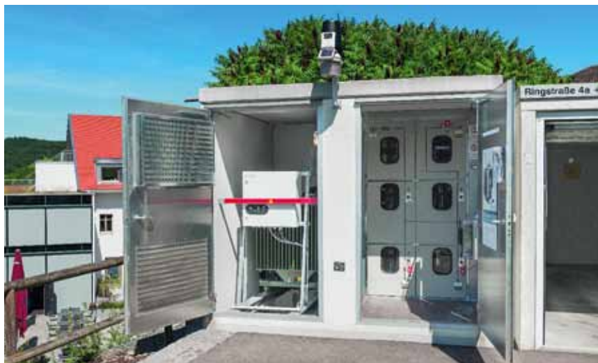
Din astfel de stații de transformare a rețelei locale, energia electrică este alimentată în gospodării prin rețelele de joasă tensiune.
