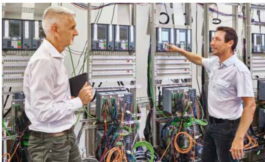
Erich Gottlieb (dreapta) de la operatorul de rețea electrică APG în conversație cu Norbert Zehetner, Siemens, înainte de configurarea testelor cu unitățile de comandă electronice.
