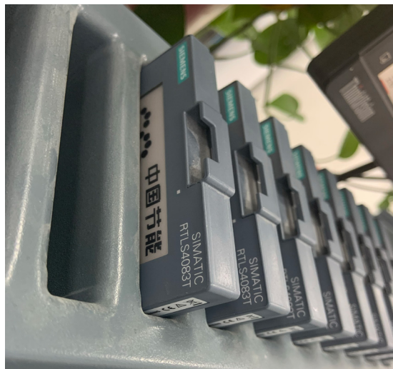
Das Echtzeit-Funkortungssystem SIMATIC RTLS ermöglicht die Ortung von Personen in unterirdischen Wasserwerken.
