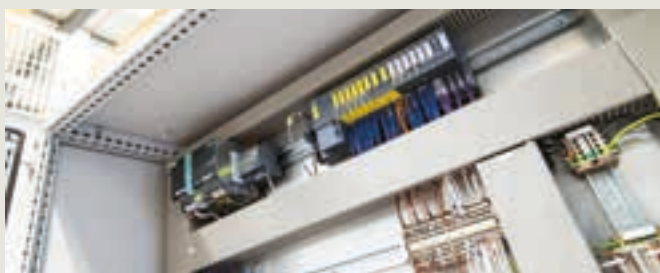
Sitop strømforsyning, Selektivitetsmodul, ET 200SP F, Fail-safe I/O moduler, Sinamics drev S120, Sirius kontaktorer m.m.
