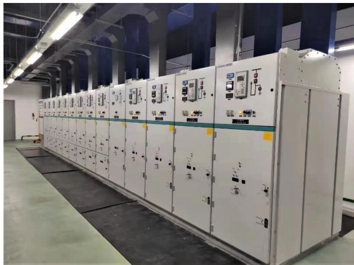
安装于1号楼的西门子中压空气绝缘开关柜 NXAirS 及微机综合保护装置 7SJ686
