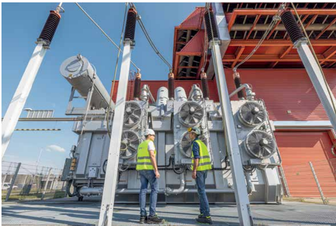
Трансформатор, свързан с генераторния прекъсвач
