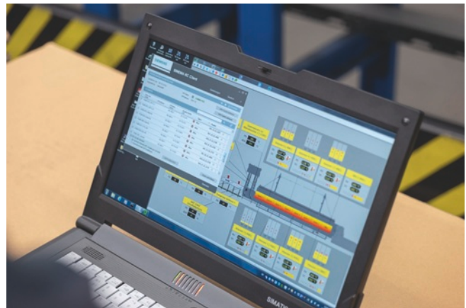
Über SINEMA Remote Connect lassen sich die gesicherten Fernzugriffe auf die Anlage per VPN verwalten und überwachen.
