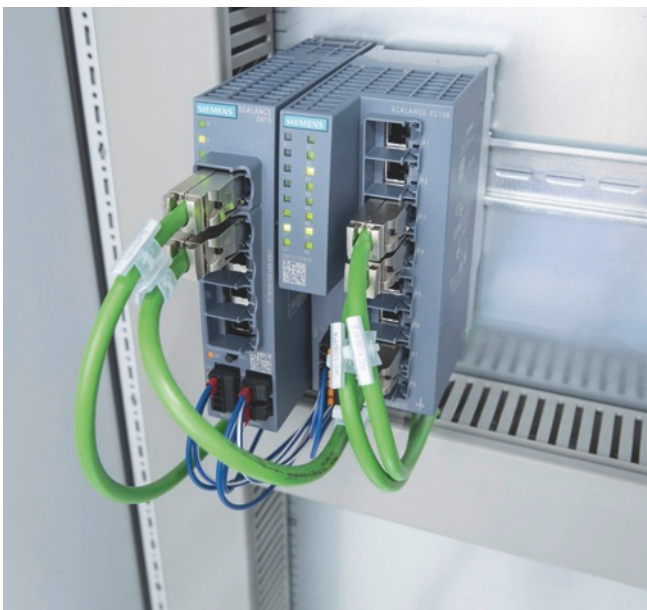
Sicheres Gateway zu den Anlagennetzen: Eine der Industrial Security Appliance SCALANCE S615 bei Simon.
