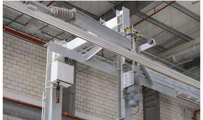
Schwenkbare Deckenstromschiene, Mekka, Saudi-Arabien
