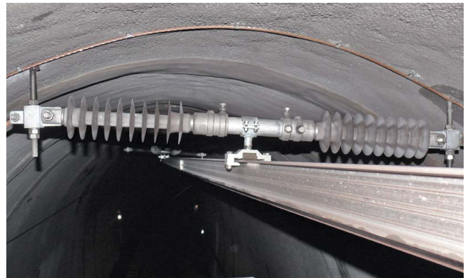
Deckenstromschiene Zimmerbergtunnel, Schweiz
