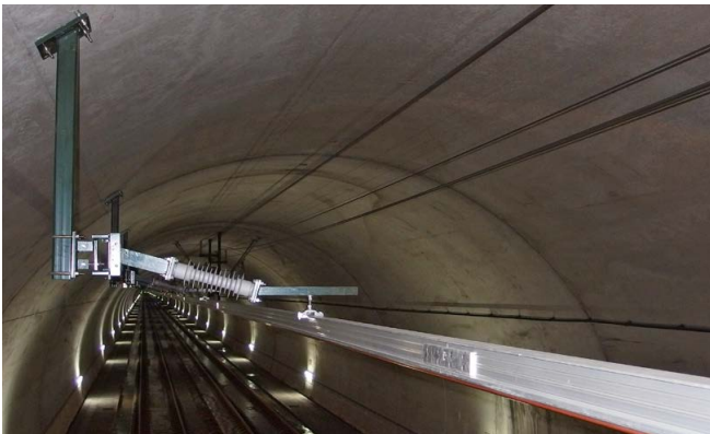
Deckenstromschiene Lantano-Tunnel, Spanien
