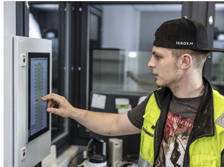
RE-pisteen kesätyöntekijä Riku Seittu saa ohjattua operointipaneelilta mm. portteja, nosto-ovia ja valaistusta.
