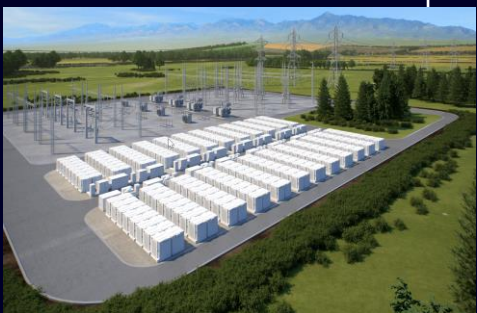
Empresa de Eletricidade da Madeira Consórcio Siemens / Fluence
