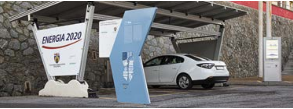
Eine von drei neuen Ladestationen für die Elektrofahrzeuge
