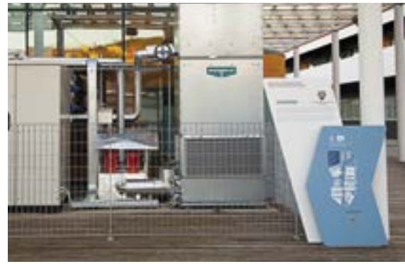
Absorptionskältemaschine, die die Abwärme der Turbinen in Kühlenergie umwandelt
