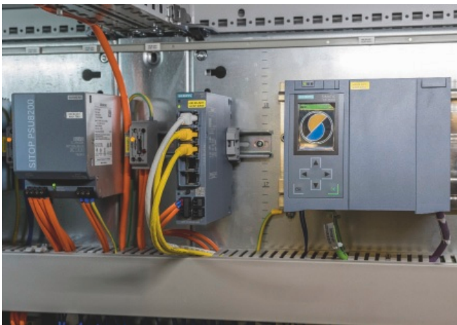
Die Security Appliance SCALANCE S615, die Steuerung SIMATIC S7-1500 sowie die Stromversorgung SITOP PSU8200 sind bei Festo im Schaltschrank eingebaute Komponenten.
