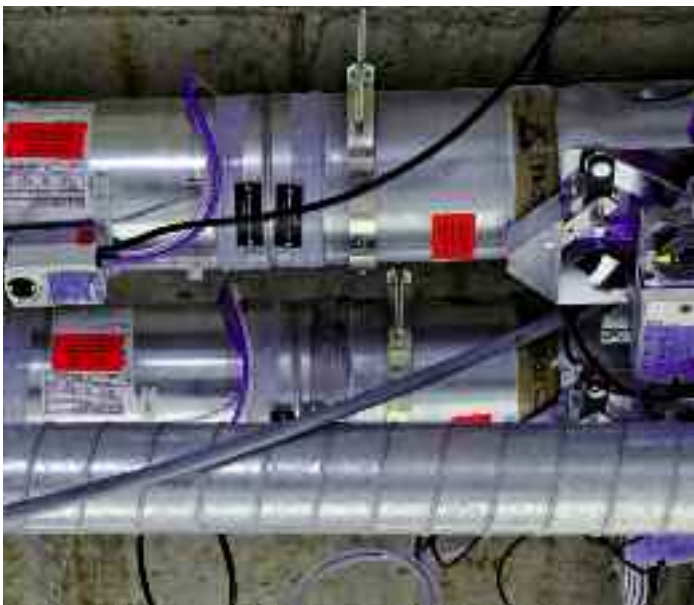
Volumenstromregler bestimmen heute den Luftstrom für die verschiedenen Zonen im Gebäude. An denselben Stellen wurden zur Sicherheit Brandschutzklappen installiert. Dies war vor 30 Jahren noch nicht vorgeschrieben.
