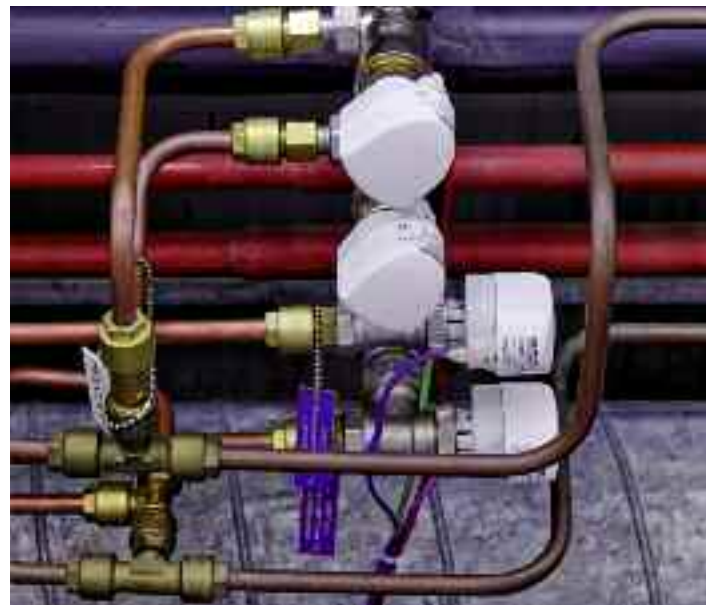
Die Ventile in den Büroräumen sind mit der zentralen Leittechnik verbunden und geben dem System wertvolles Feedback.
