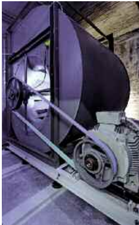
Die über Frequenzumrichter angetriebenen Ventilatoren für die Zu- und Abluft laufen nur so stark wie nötig.
