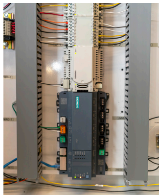
Siemens Desigo PXC controller
