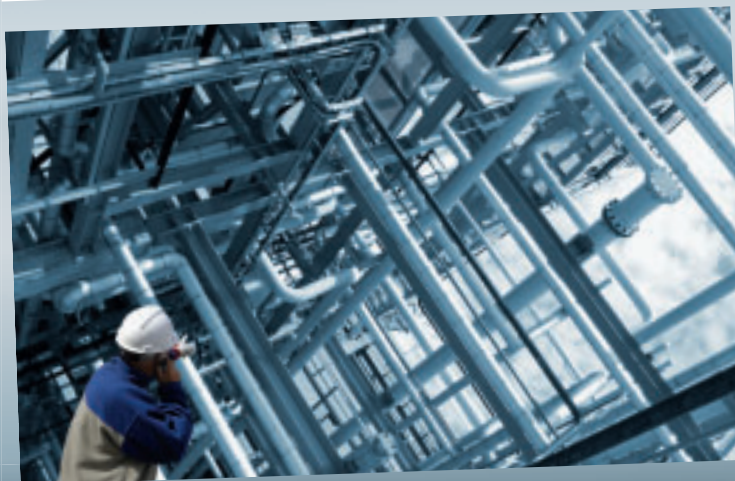
Den Überblick behalten: gerade in komplexen Prozessanlagen bei der Instandhaltung entscheidend
