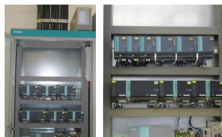
Figura 1: En este armario eléctrico de control de una instalación de grúa se ha sustituido un SAI de AC, que por su tamaño tuvo que montarse encima del armario (fotografía de la izquierda), por tres SAI de DC. Dado que además se utilizó la generación de fuentes de alimentación compactas SITOP PSU300M 24 V / 20 A, las tres fuentes de alimentación se adaptaban a las tres SITOP UPS500S 15 A / 5 kW en el mismo perfil DIN simétrico.
