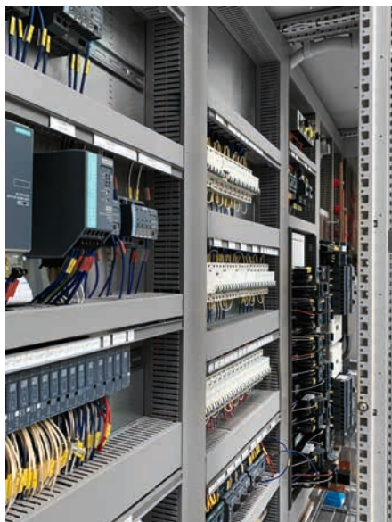
Strömförsörjning, I/O-system, dvärgbrytare och startapparater.
