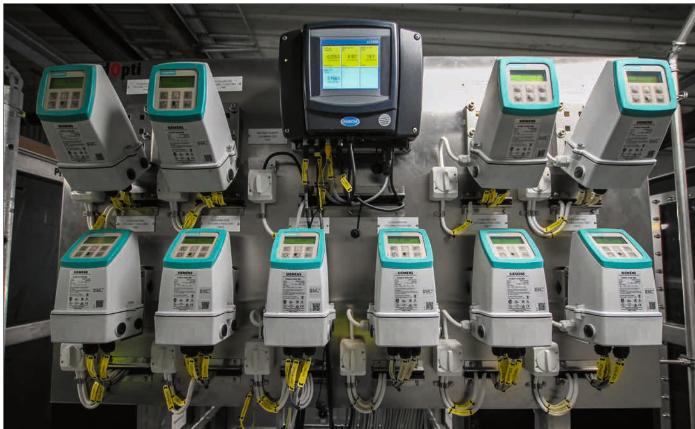
Anläggningen är full av processinstrument från Siemens.
