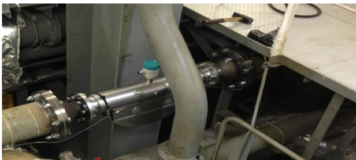
Medidor de trasiego DN80 entre tanques
