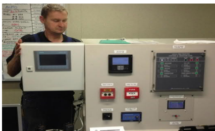
Sala de control
