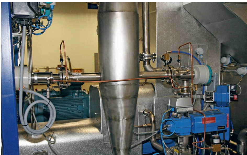
Det vägräta röret är en gasanalysator från Siemens som mäter syrehalten i processen. Längst upp till vänster syns en av Siemens tryckgivare, Sitrans P DS III med Profisafe.
